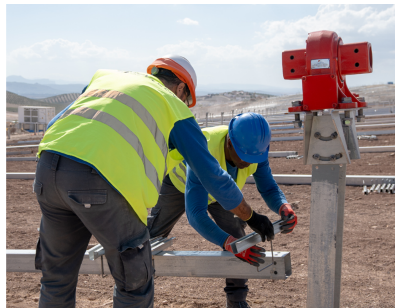
Planta Fotovoltaica "PFV Guadacano" Antequera y Archidona (Málaga)
