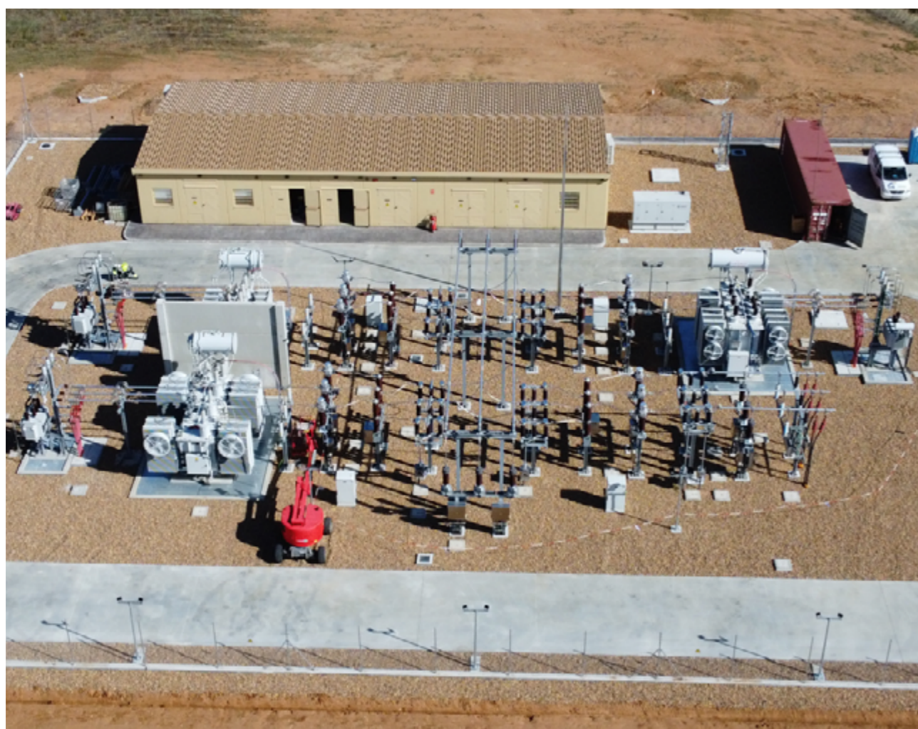
Subestación digital Majuelo 66/30 kV
