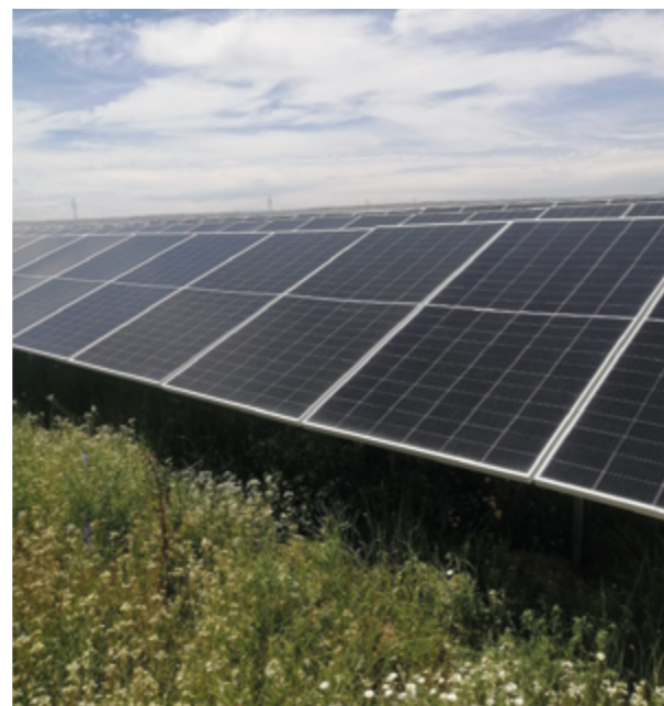
Planta Fotovoltaica "Toscano Solar" Cubillos (Zamora)
